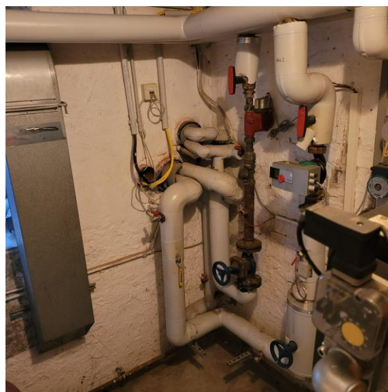
Gasheizung Verrohrung und Steuerung
