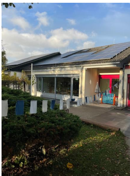
PV-Anlage KITA Dach
