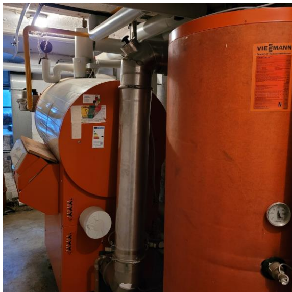
Gasheizung Kessel und Puffer
